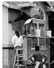
Obreros trabajando sin usar casco: no-protección contra equipos que caen
