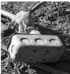
Cordón Eléctrico desgastado
